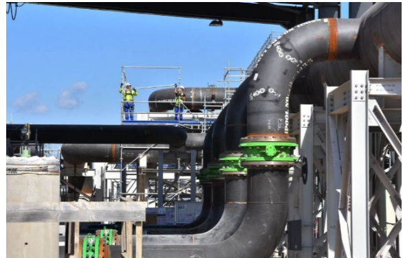
図2 CWS大口径配管
