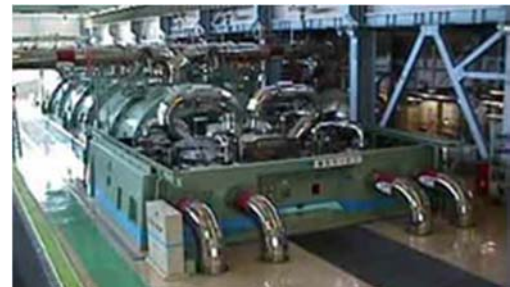
タービン発電機
